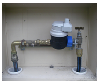
La télé-relève est installée sur chaque compteur
